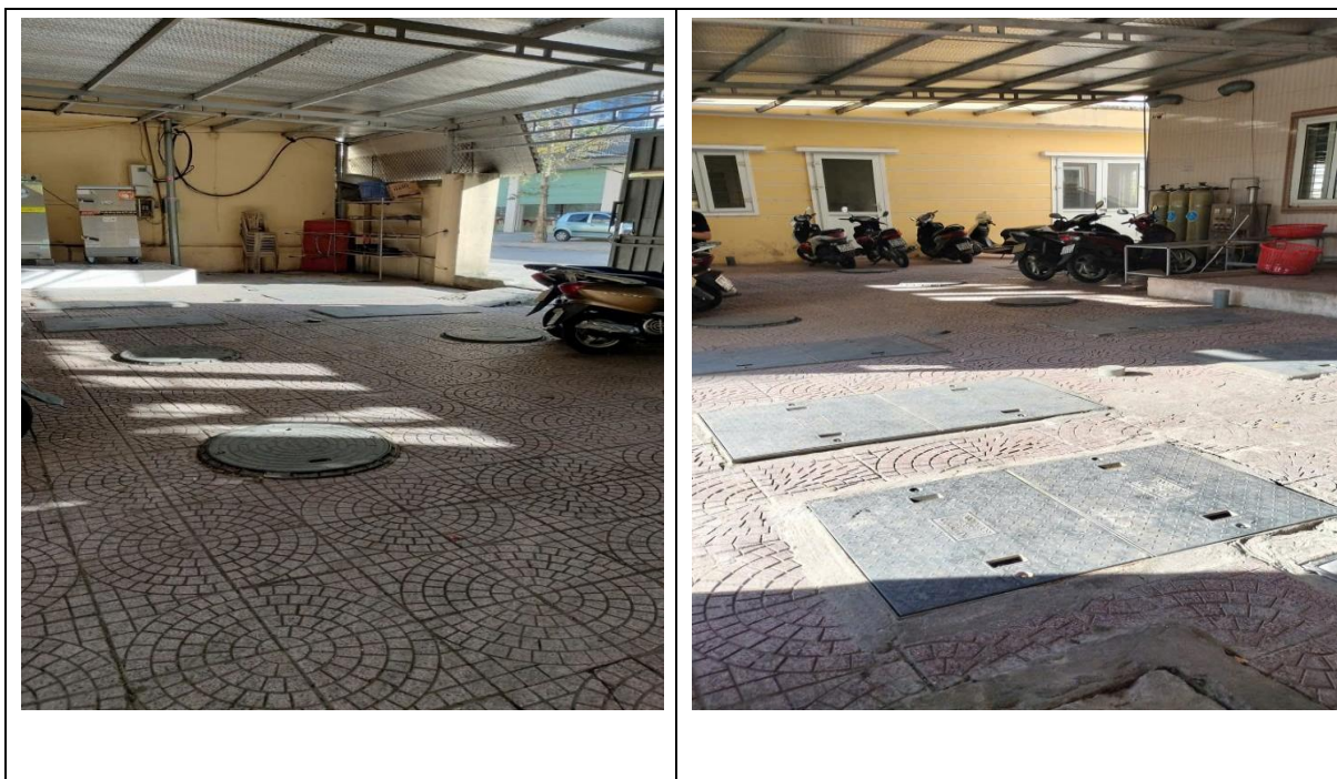
Hình 8. Hệ thống xử lý nước thải đã xây dựng của cơ sở
